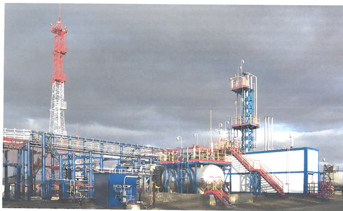
Газоснабжение Камчатской области. Обустройство Кшукского и Нижне-Квакчкского газоконденсатных месторождений. Установка комплексной подготовки газа. 1-й пусковой комплекс.
